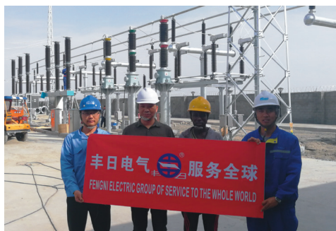
非洲肯尼亚电力系统工程 Kenya power system engineering in Africa
